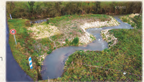
Création d'un bras de contournement sur le Négron au Moulin de Bariteau en 2023.
